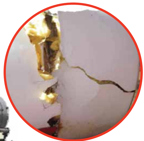
Rotura de la aislación térmica
